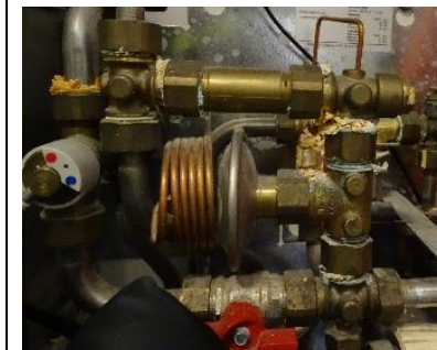
Eksempel på brugsvandsinstallationen i teknikskab
